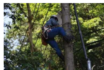
柱上開閉器操作(解列)の様子
