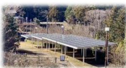
太陽光発電設備
